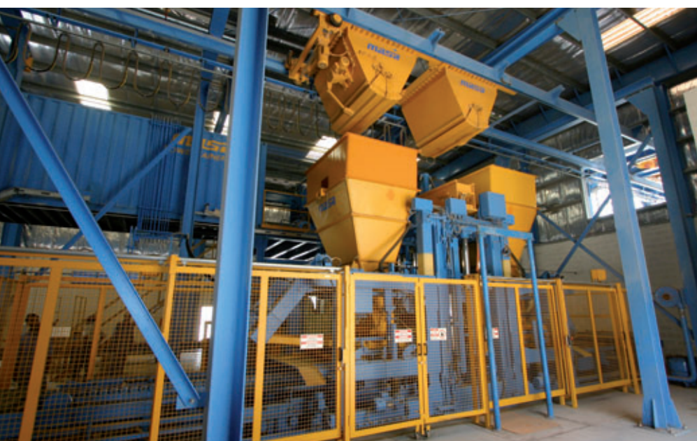
Machine à fabriquer les blocs XL 9.2 avec convoyeur à bennes
