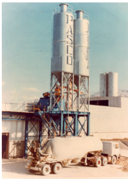
Pasco No. 1 avec installation de mélange
