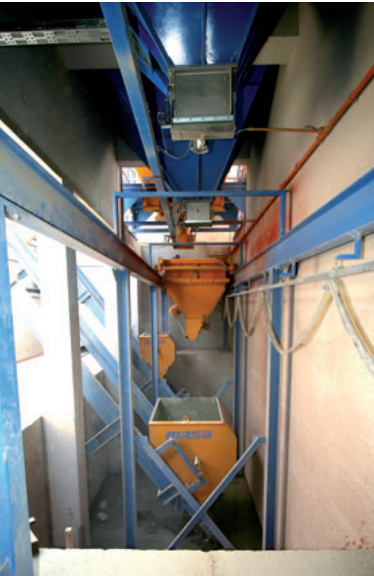
Masa fahrbarer Wiegebehälter mit Mischeraufzug
