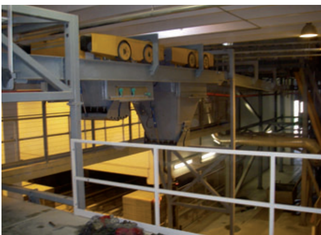
Transport du béton avec le Skako Conflex (une benne de 0,75 m 2 et une de 2 m 2 )
