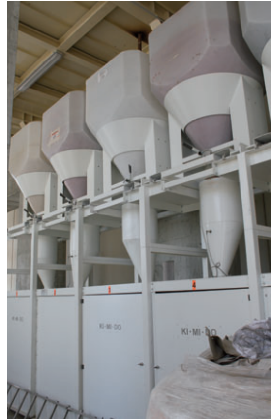
L'impianto di dosaggio del colore dalla tedesca Kimido Kindler GmbH
