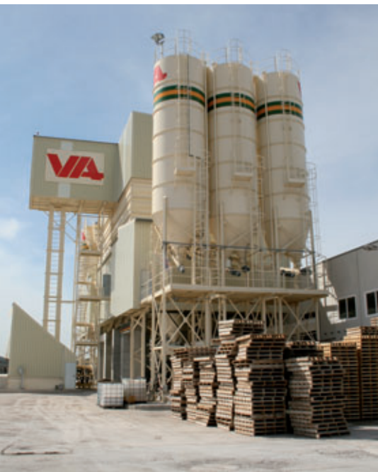
Die Mischtechnik wurde von der spanischen Firma Frumecar geliefert
