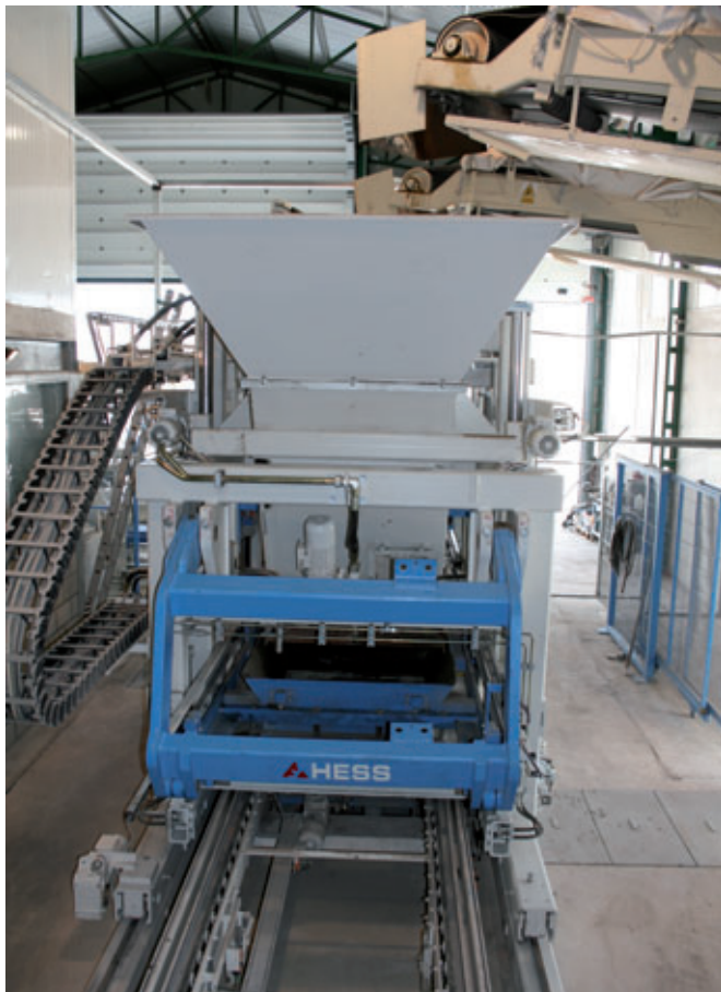
Die Betonsteinfertigungsanlage RH1500-2 VA wird über ein Fließband beschickt
