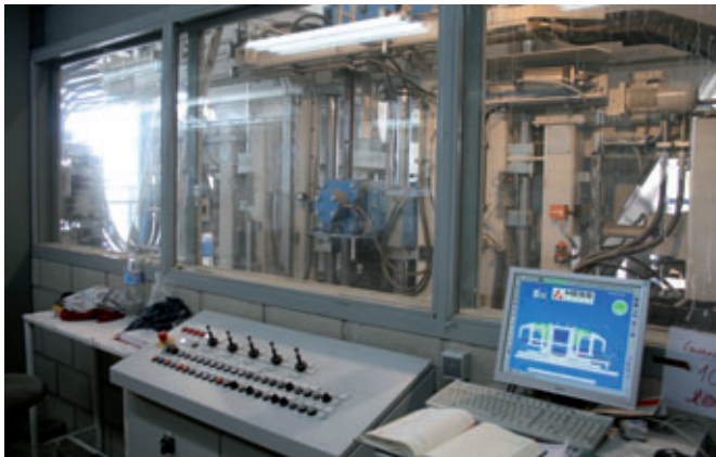
Mischer und Betonsteinfertigung lassen sich aus dem zentral gelegenen Steuerraum überwachen
