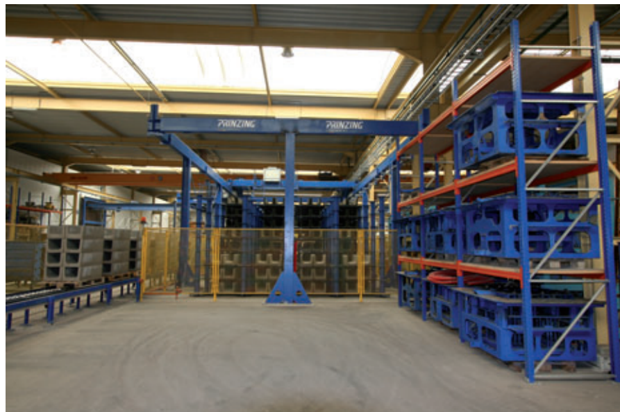
A Roeselare durante la progettazione dell'impianto è stato tenuto conto della possibilità di ampliare la scaffalatura di stagionatura per un eventuale secondo turno
