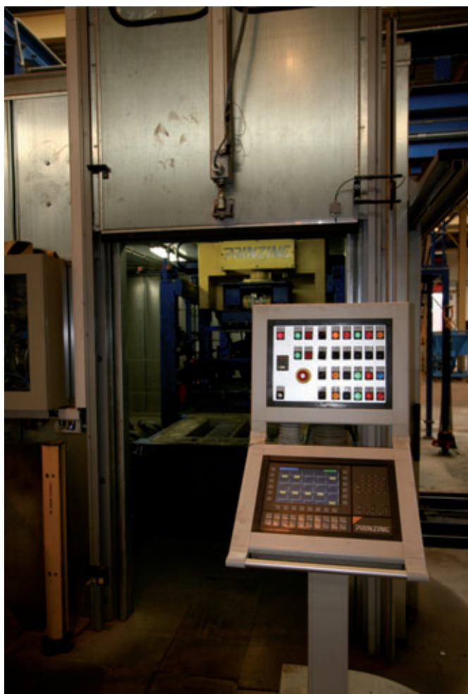
Sui monitor del quadro di comando Blizzard è possibile controllare tutti i parametri relativi alla produzione
