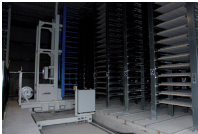
Fig. 3: Le chariot transbordeur emmène les planches de support sur les rayonnages de durcissement de la société Rotho aménagés en face de l'installation.
