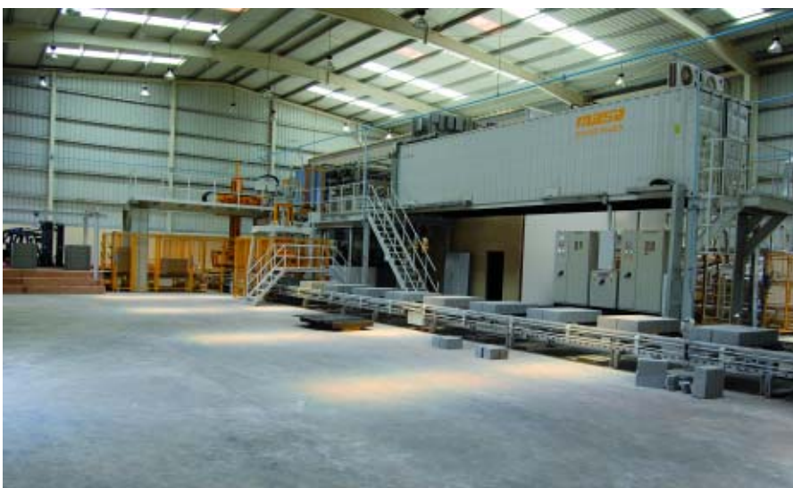
Все секции электрического контроля для всего завода помещены в единый шкаф
