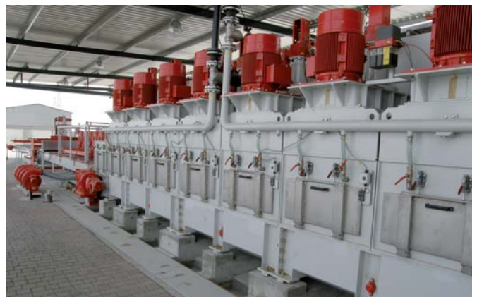
Die Schleifmaschine hat acht Stationen zum Fräsen, Glätten und Schleifen.
