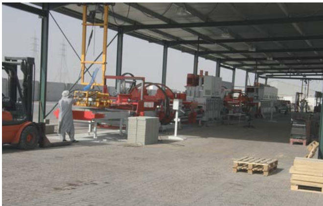
Die Veredelungsanlage beginnt mit einem Gurtförderer zum halbautomatischen Auflegen der Steinlagen mittels kundenseitiger Klammer.
