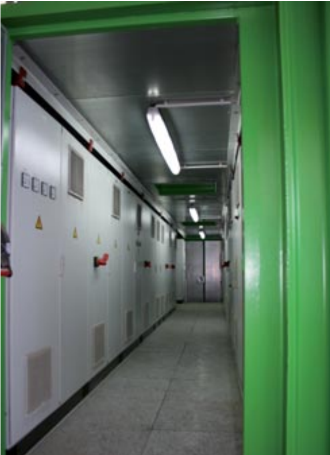
Z prawej strony maszynowni, w której znajdują się agregaty hydrauliczne, zainstalowano drugi kontener Powertainer
