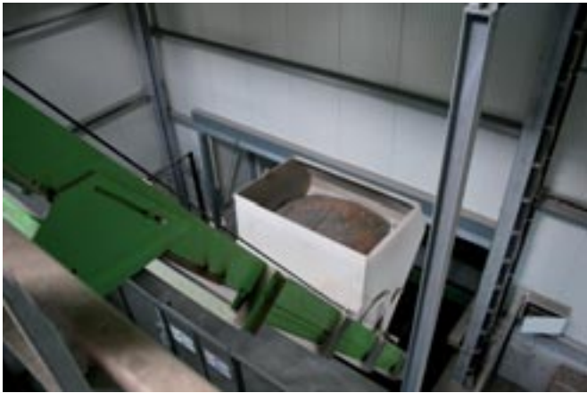
Surowce są transportowane windami do obydwu mieszarek.
