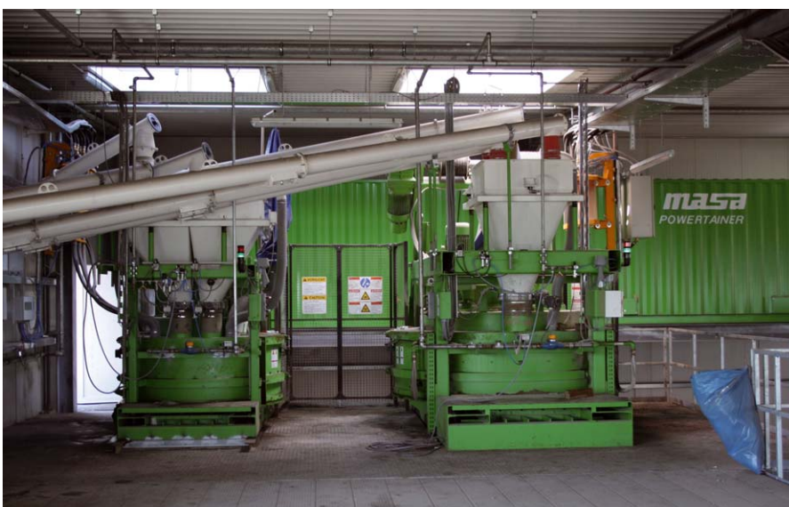
Deux mélangeurs forcés horizontaux de fabrication Masa produisent du béton de parement et de remplissage destinés à la fabrication de blocs (illustrés avec un « Powertrainer » de Masa).
