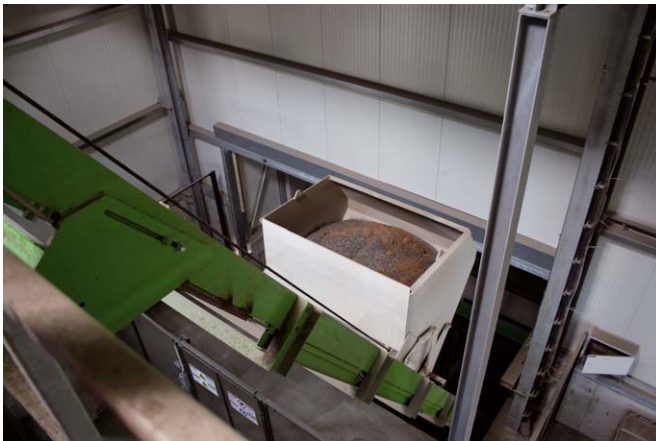
Les deux mélangeurs sont alimentés par des élévateurs.
