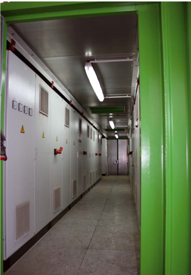
Rechts vom Maschinenraum, in dem sich die hydraulischen Aggregate befinden, ist der zweite Powertainer angeordnet.
