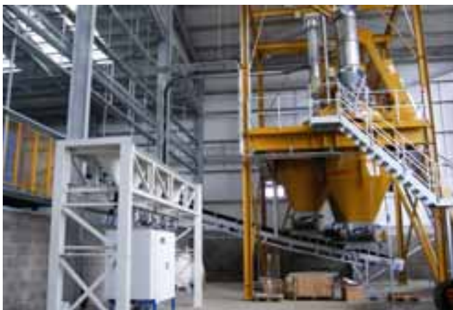
Il mescolatore da 4.500 litri della Haarup produce ogni 3 minuti 7 tonnellate di materiale. A sinistra: l'impianto di dosaggio del granulato di 4 colori della Würschum
