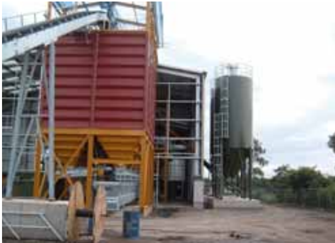
6 réservoirs de stockage et 2 silos à ciment de 100 tonnes chacun
