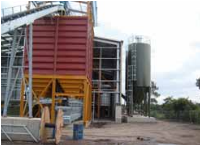
6 Lagerbehälter und 2 Zementsilos, je 100 Tonnen
