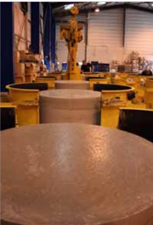
Nach einem Tag werden die Schachtunterteile, die am Vortag produziert wurden, wieder ausgeschalt.
