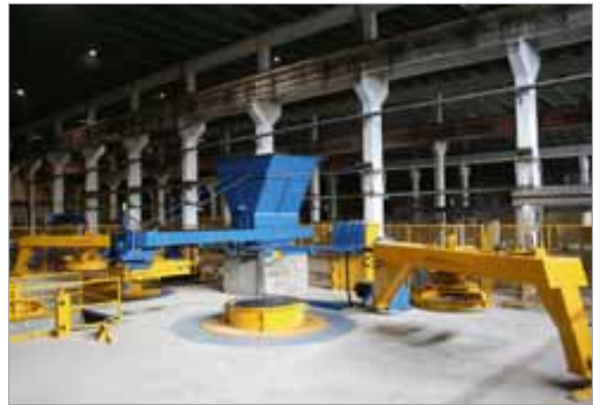
Vue d'ensemble de l'installation de production EXACT XL : Entre les deux stations pour la production de tuyaux et d'éléments de regards on peut voir les convoyeurs de béton et le poste de commandes.
