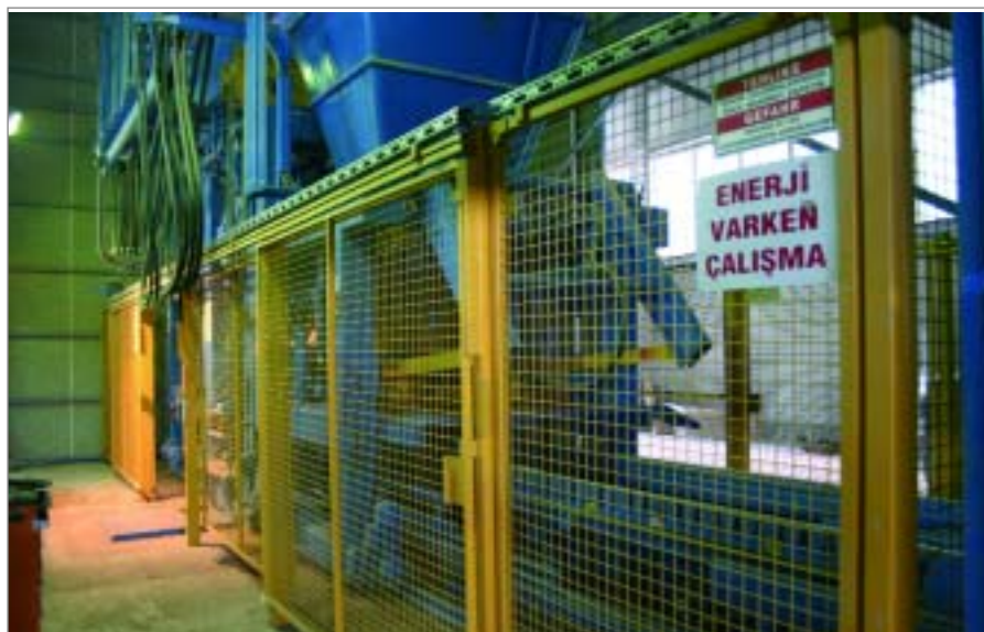
В соответствии с инструкцией по технике безопасности машина для изготовления бетонных камней, установленная на предприятии фирмы Ozkul, обнесена оградой.
