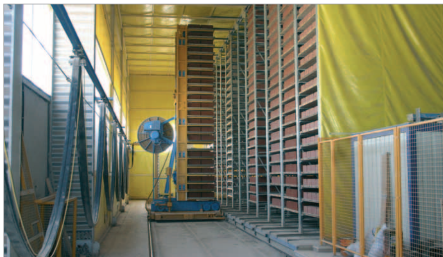
Le pont-roulant entièrement automatique charge et décharge l'installation de rayonnages entièrement automatique
