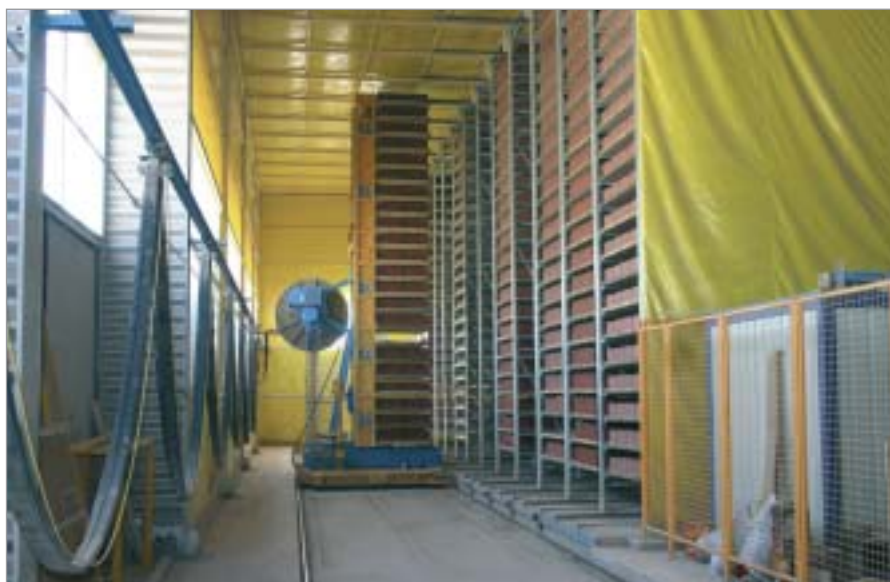
Die vollautomatische Schiebebühne be- und entlädt die Regalanlage vollautomatisch
