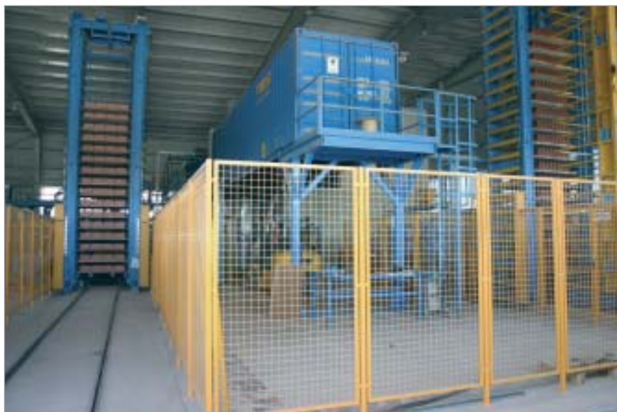
In dem 40' Container – bei Masa genannt: Powertainer – sind alle Steuerungen vorinstalliert enthalten.
