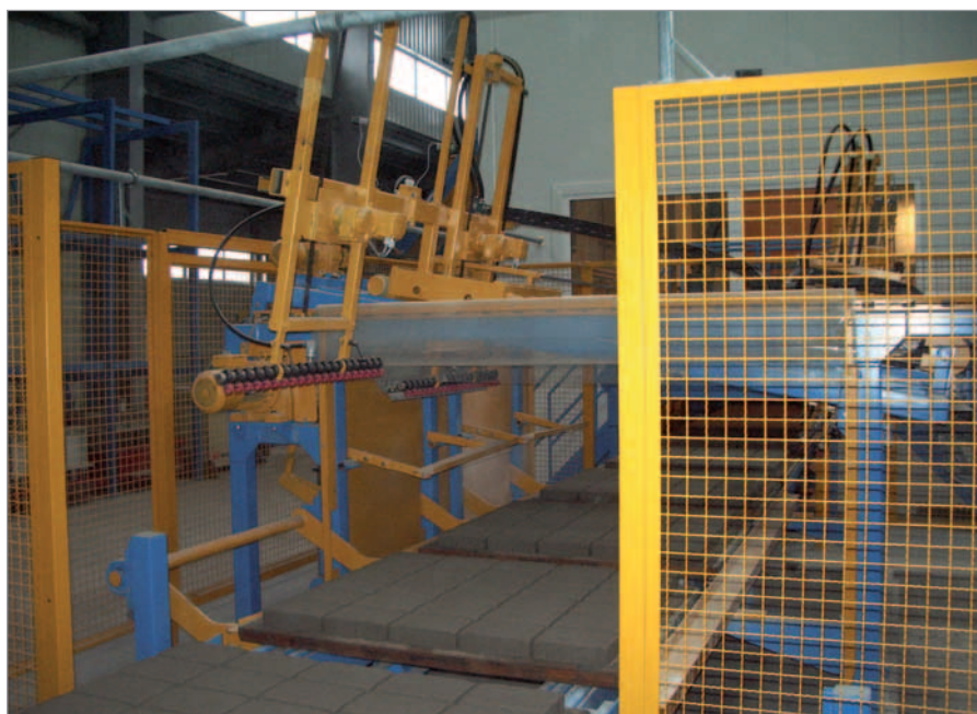
I blocchi di calcestruzzo prodotti dalla blocciera vengono trasportati al dispositivo di sollevamento da un dispositivo di abbassamento e da un trasportatore a corsa libera.
