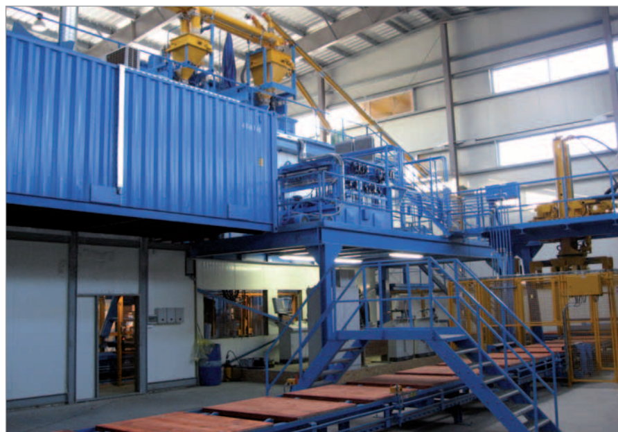
L'installation de mélange et de dosage est placée directement au-dessus de la machine à mouler les blocs.
