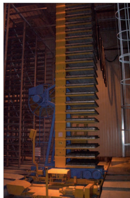
Le pont-roulant entièrement automatique et rotatif charge et décharge l'installation de rayonnages de HS qui a été mise en circuit fermé avec une installation à circulation d'air.
