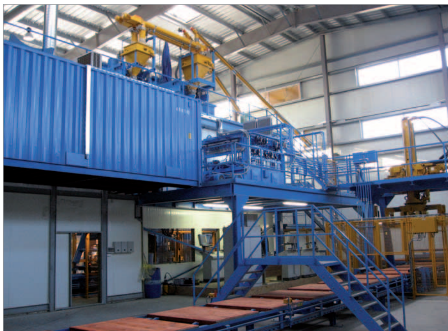
Die Misch- und Dosieranlage ist direkt über der Steinformmaschine platziert.
