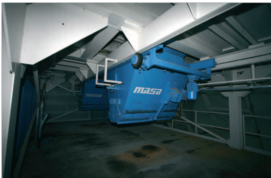
Die Doppelkübelbahnanlage besitzt ein Fassungsvermögen von insgesamt 6.400 l
