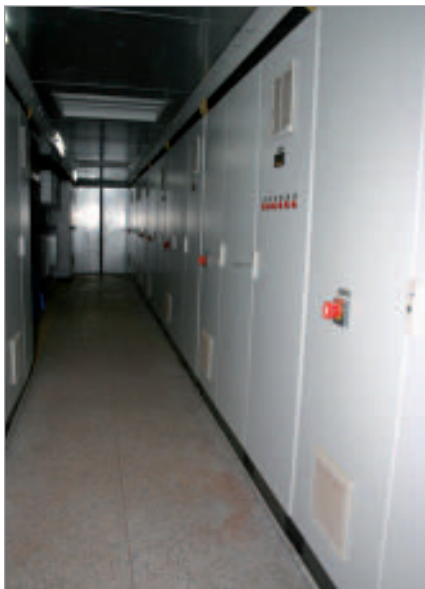
Interno di "Powercontainer" della Masa
