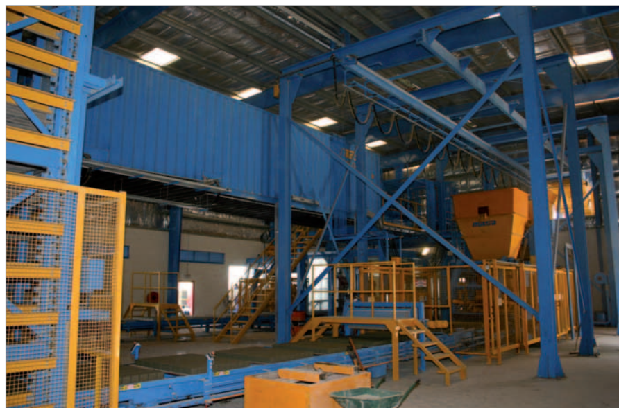
Produkttransport auf der Nasseite und Schaltschrankcontainer
