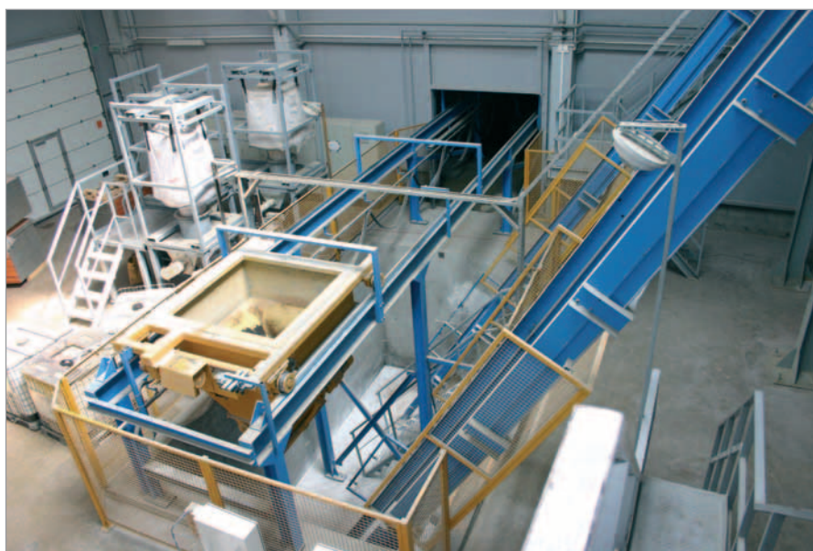
Les granulats sont pesés par la balance de chargement et chargés dans les élévateurs du mélangeur
