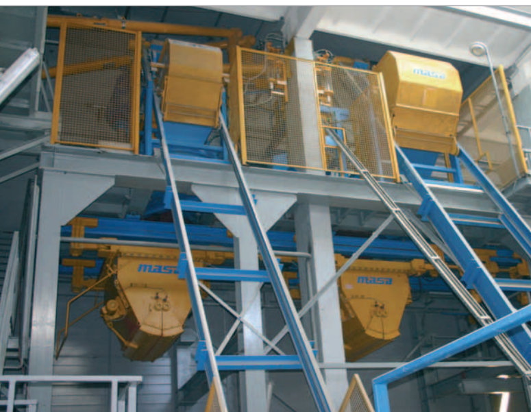
Deux mélangeurs à mélange forcé horizontal Masa prennent en charge la production de béton de remplissage et de béton de parement, celui-ci étant transporté par la suite par le convoyeur à bennes à doubles chariots vers la presse à blocs de béton.
