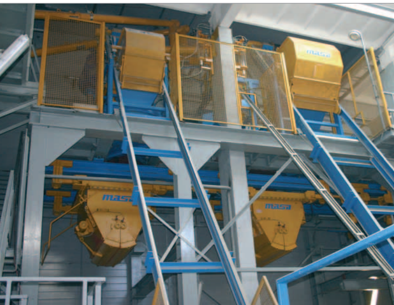
Zwei Masa-Horizontalzwangsmischer übernehmen die Produktion von Kern- und Vorsatzbeton, der dann von der Kübelbahn mit Doppelwagen zur Steinfertigungsmaschine transportiert wird.
